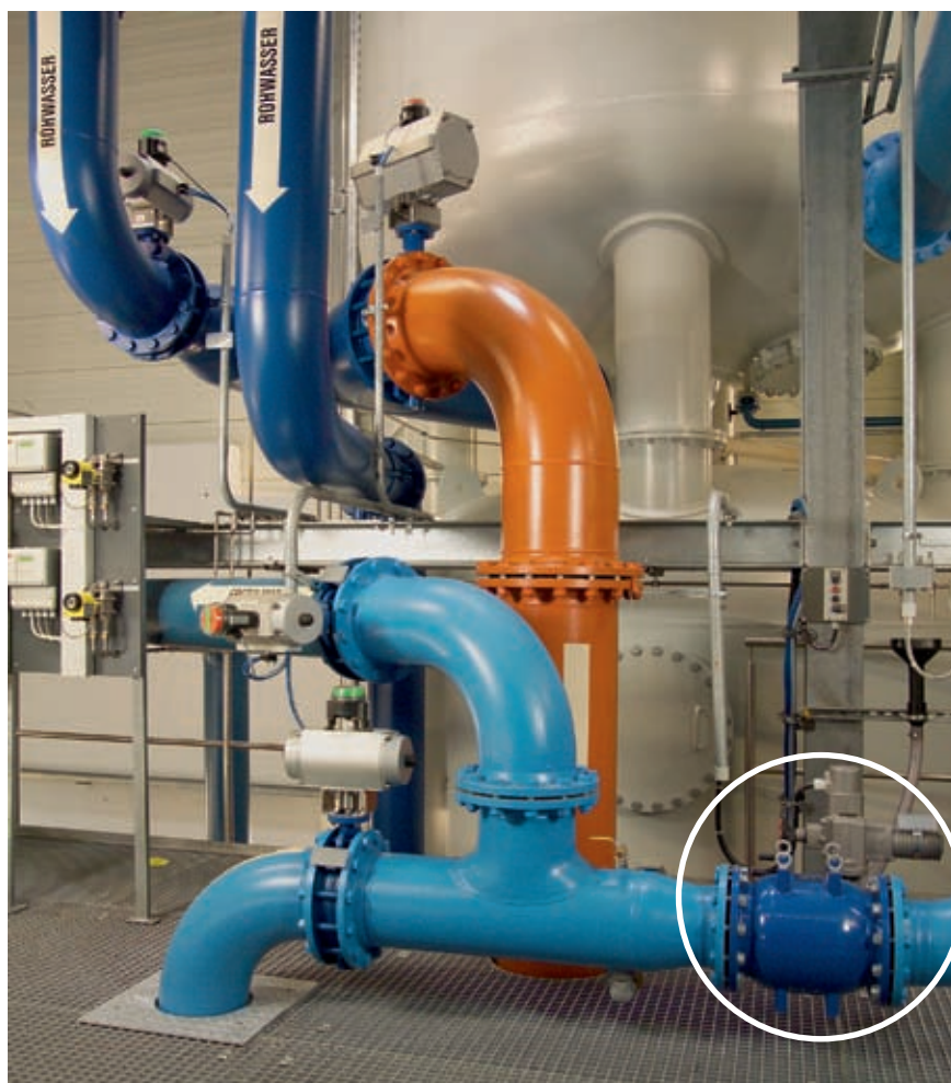
Bild 3: VAG-RIKO®-Ringkolbenventil DN 150 (Kreis) in der Wasseraufbereitungsanlage Kleine Kinzig
